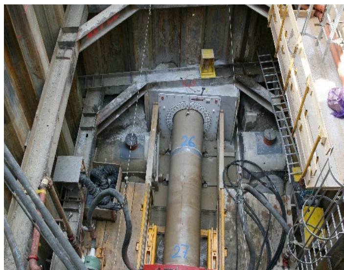
Alimentation Genève Lignes 15kV CFF 2018 - 2020
